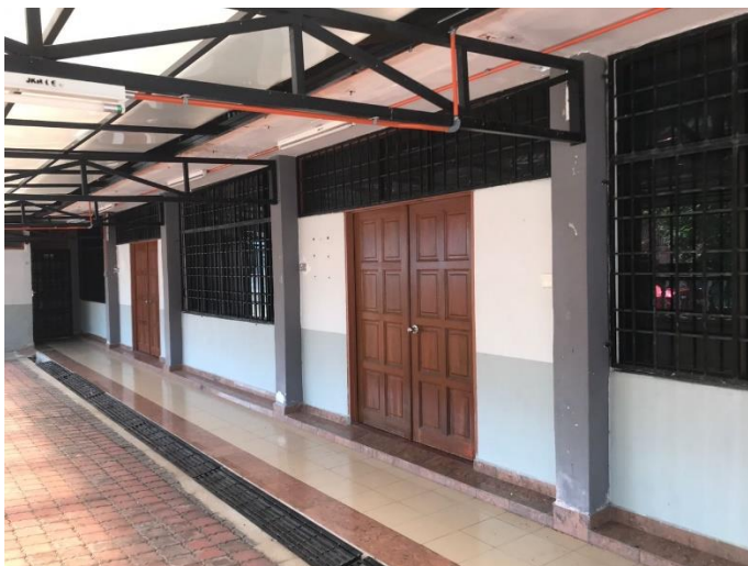
Keadaan semasa pintu dewan (untuk dipasang sliding grille ).
