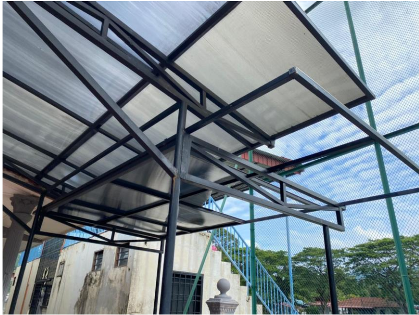
Keadaan semasa bumbung polycarbonate di luar dewan
